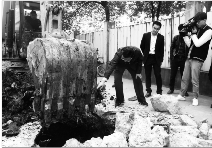
挖掘机在苏州宝隆金属涂装有限公司院内进行挖掘，发现了污水偷排暗管。闫艳摄
