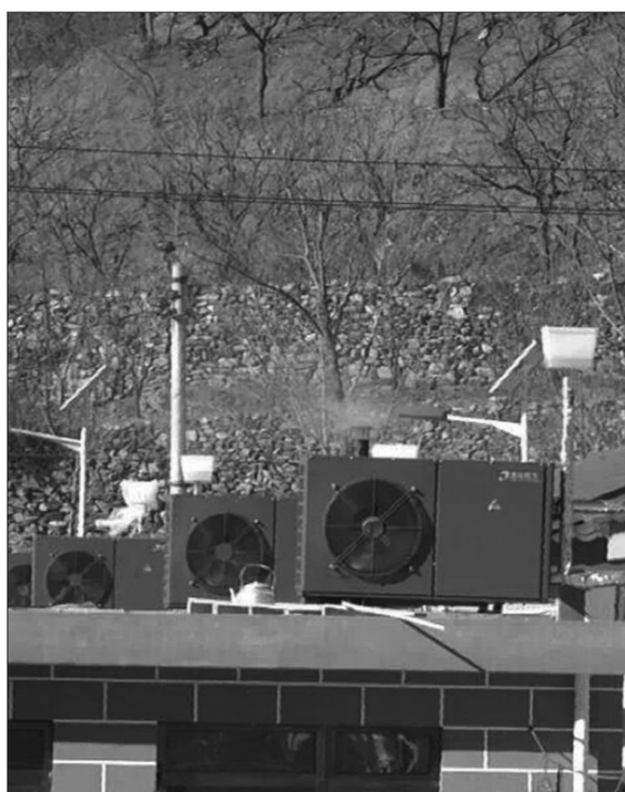
图为村民屋顶上的空气源热泵主机。
