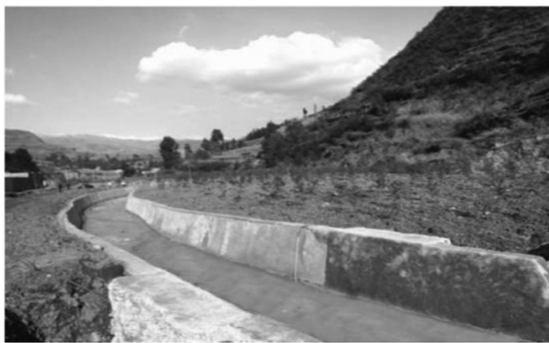
六盘水大湾镇利用原位修复技术开展实施铅锌重金属综合防治工程。上图为治理前,下图为治理后。岳植行供图
