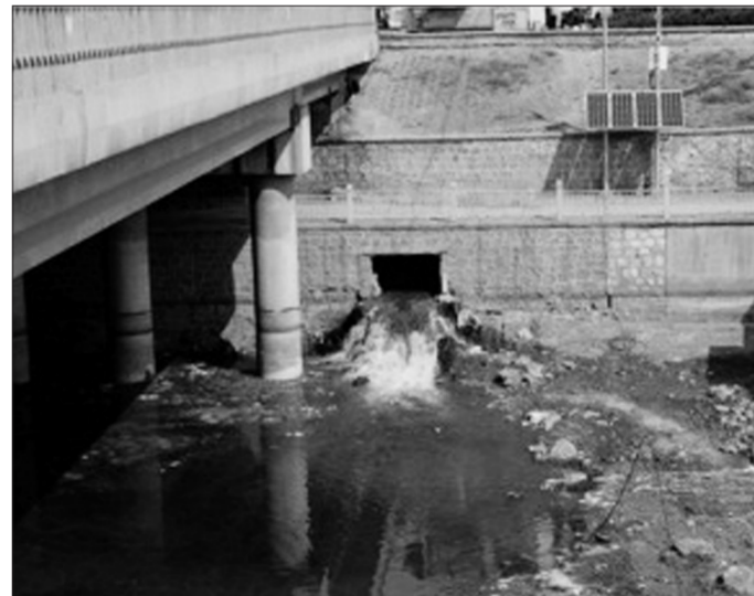
图为北京光耀桥一处向通惠河排放废水的入河口。刘敬奇供图
