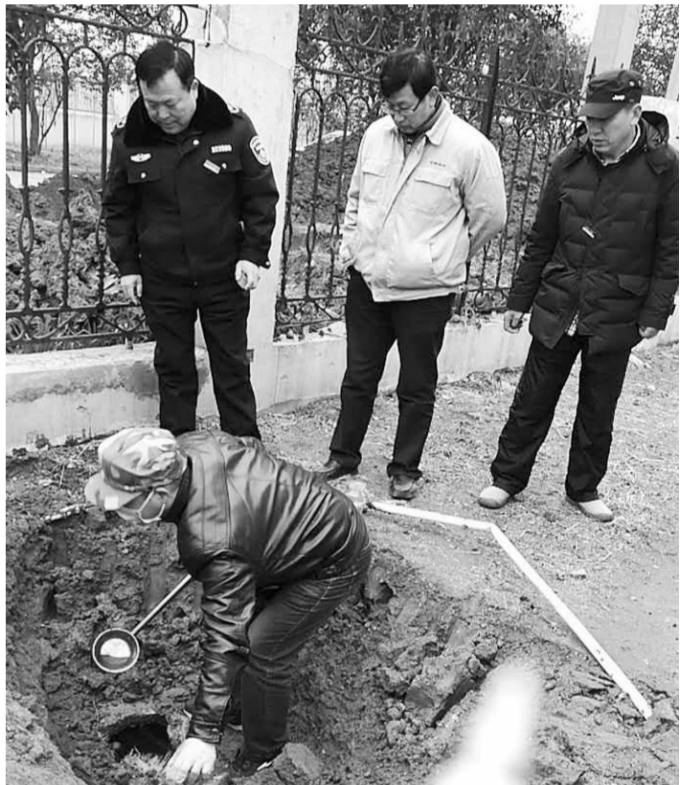
江苏省宿迁市宿豫区环保局执法人员日前在巡查企业排放管网时发现,某企业私设暗管排放未经处理的生产废水。经宿豫区环境监测站取样监测,废水中化学需氧量、悬浮物等水污染物浓度分别超标近13倍和0.5倍。目前,该企业已被罚款10万元,分管环保的负责人被警方行政拘留10天。该企业随后缴纳了罚款,并已停产整治。 图为通过现场机械挖掘后,暗管露出原形。 本报见习记者韩东良 通讯员徐万宁 吴向虹 陆迅摄影报道
