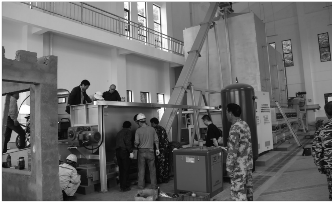
一套无需辅助加热和添加微生物发酵的农村生活有机垃圾处理设备,近日在浙江省舟山市普陀区桃花镇生活垃圾减量化处理中心安装完毕并进行调试。桃花镇各家各户所产生的生活垃圾将全面实施分类收集处理。邢学火摄
