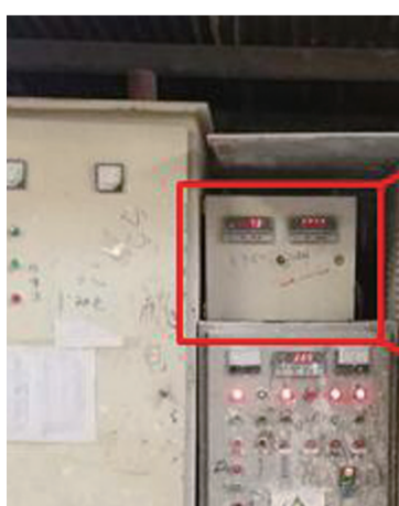
▼新玻尔瓷业有限公司布袋除尘控制设施指向“直排”。
