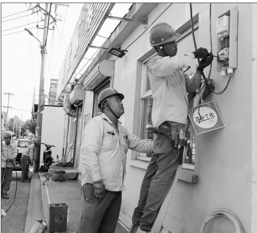
2017年是北京市2013~2017年清洁空气行动计划的收官年。今年,北京市将再完成4000蒸吨左右燃煤锅炉清洁能源改造,实现市域范围内10蒸吨及以下燃煤锅炉清零;将完成1万蒸吨燃气锅炉低氮改造任务,在农村地区取消700个村庄住户取暖用煤。图为国家电网北京朝阳分公司的工人在王四营乡李罗营村煤改电项目现场为用户安装智能峰谷电表。 本报记者邓佳摄
