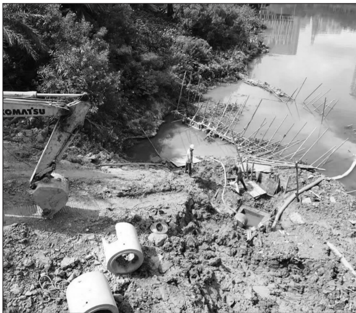
在南湖一竹排江东湖桥东南面排放口工地现场,一辆挖土机正在作业,几名工作人员在安装大型排污管道。
