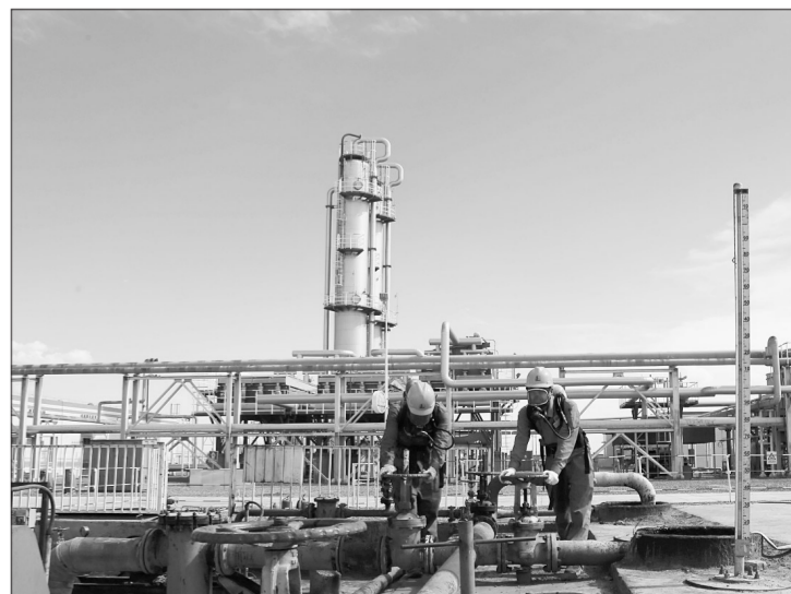
西北油田采油二厂二号天然气处理站通过增建一套络合铁脱硫回收硫磺装置,处理胺法脱硫后高含硫再生酸气,应用效果较好。回收硫磺产品纯度高、质量好,经处理后的酸气达到国家排放标准,可减少二氧化硫排放达2000吨以上。图为员工正在调试硫磺处理阀门。 胡强 朱清峰摄
