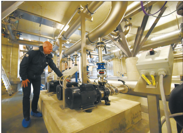
奥胡斯水厂运营主管迈克尔·罗森伯格在检查泵房。根据奥胡斯市政部门对地下水资源的测量和规划,这个市周边需要重点保护6500公顷土地以防止地下水资源受到污染。农民不能在这些被保护的地上使用杀虫剂等化学制品。
