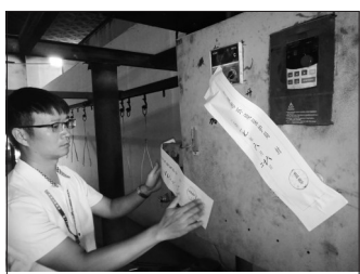
6月26日,执法人员依法查封米超五金电器厂电箱。
