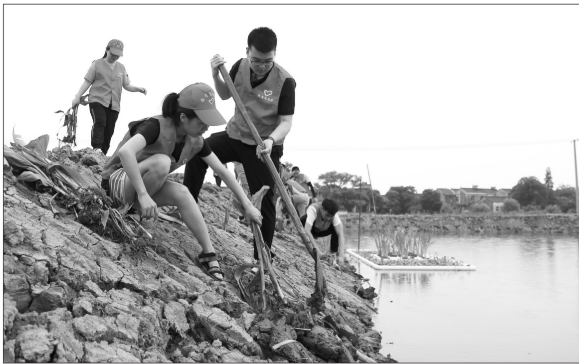
浙江省乐清县洛舍镇是水产之乡,2017年渔业养殖尾水治理目标面积为8000亩。据悉,渔业养殖尾水流入沉淀池,经过滤吸附坝、曝气池、生物净化池、人工湿地后达到达标排放,可以有效改善水环境,治理农业面源污染,循环利用水资源。 人民图片网供图
