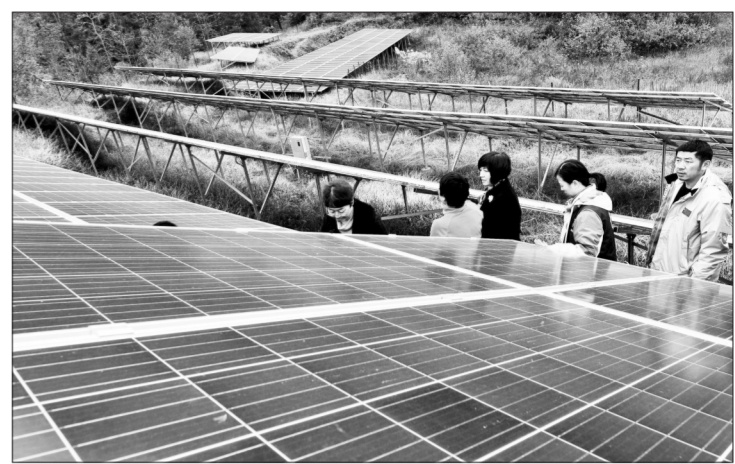
陕西省宁强县光伏电站近日并网发电。在光伏板下面还可以利用地面种植喜阴的中药材和菌菇等经济作物。 人民图片网供图
