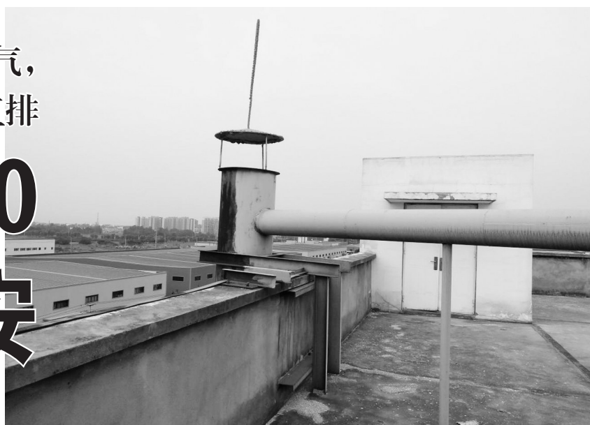
与干燥工程排风管网相连的排气筒。
