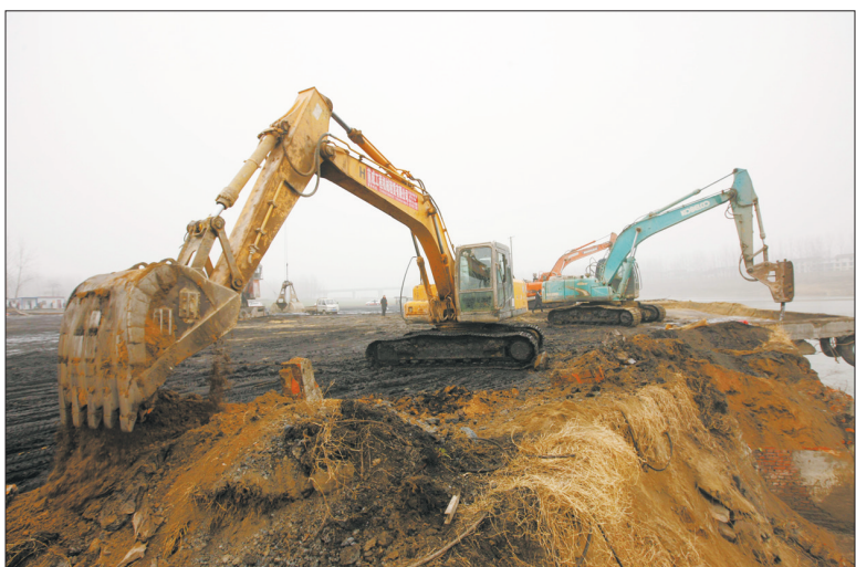
为保护水域生态环境,安徽省蒙城县近日组织多部门联合对境内涡河岸边5处非法码头及相关设施进行依法拆除。涡河是淮河的第二大支流,长380公里,流域面积1.59万平方公里。 人民图片网供图
