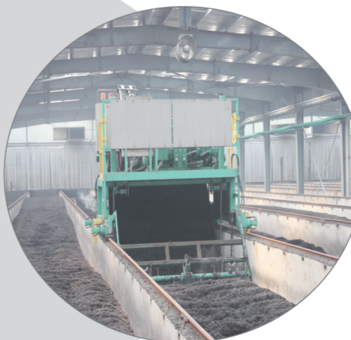
沈阳市污泥干化示范工程
