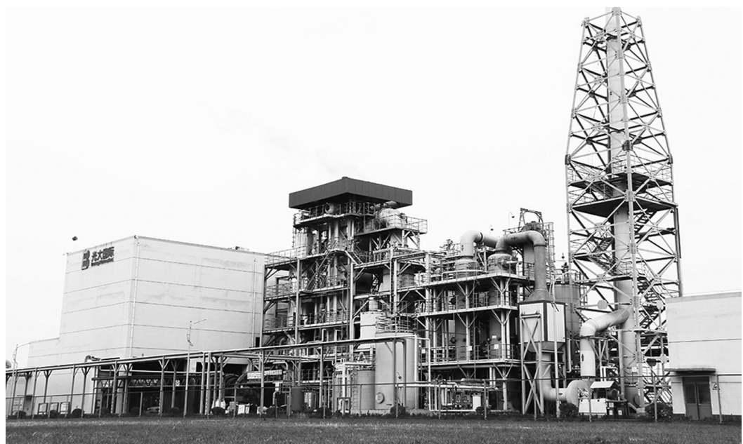
位于江苏省北部的新沂光大绿色环保有限公司静脉产业园危废焚烧项目已运行一年半,处置能力达1万吨/年;目前,病死畜禽焚烧项目土建设已完成,正在安装设备,预计年底投入运行。图为厂区一角。 蒋绍辉摄
