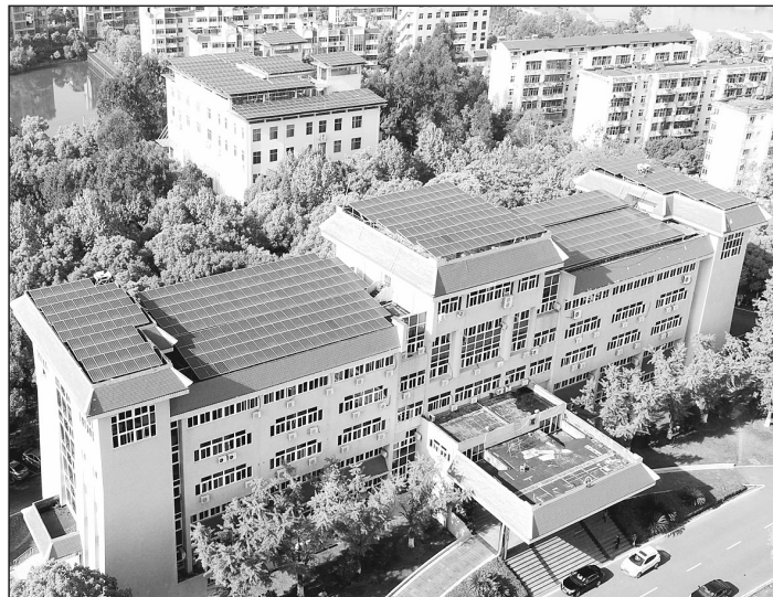
江西省峡江县政府大楼屋顶分布式光伏发电项目近日建成并投入使用。据悉,这个项目的装机容量达480千瓦。人民网供图
