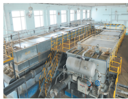
课题研发的防堵塞溶气气浮技术应用工程
