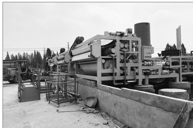
泰兴污泥处置现场,已安装4台压滤机。
