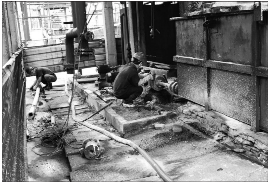
厂区内跑冒滴漏现象严重。
