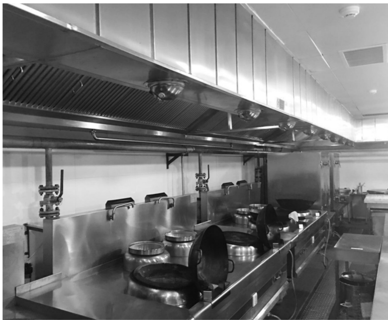
图为北京市丰台区某养老中心采用WSY-1紫外汞齐灯油烟净化装置的厨房,图片上方竖条区域为装置系统。 资料图片
