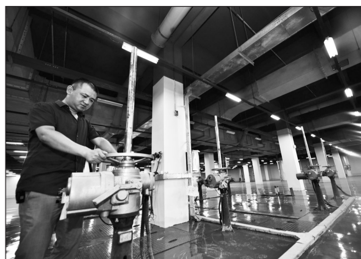
安徽省首家全地埋式污水处理厂——合肥清溪净水厂近日建成投入使用。该污水处理厂的污水处理构筑物、处理设备、综合管线、地下交通等,都集中布置在地下箱体内,在节约土地占用面积的同时,能够有效防止噪声污染和空气污染。清溪净水厂处理后的出水水质将达到地表水IV类标准。图为工作人员在调整进水管阀门。 人民图片网供图
